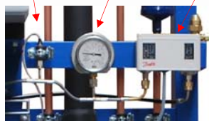
Bild 1: Steuerung Fig. 1: Control
