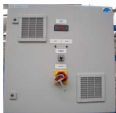
Bild 2: Elektroschaltschrank mit elektr. Regler zur Saugdruckregelung Fig. 2: Electrical Panel with electronic Controller for suction pressure control
