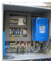
Bild 3: Elektroschaltschrank mit eingebautem Frequenzumformer Fig. 3: Electrical Panel with mounted Frequency Converter
